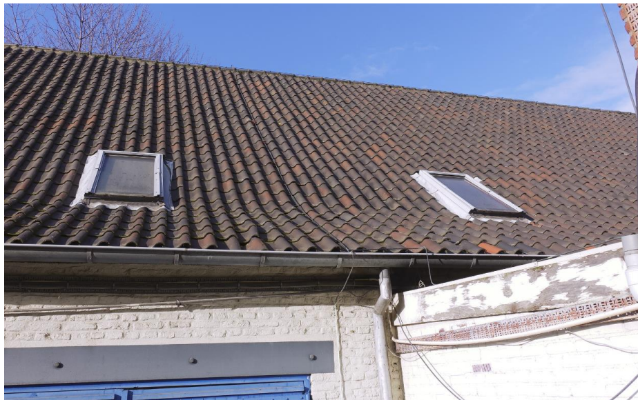
Zicht op de dakbedekking van romaanse pannen en dakvensters in het oostelijke dakvlak van na 1940.
