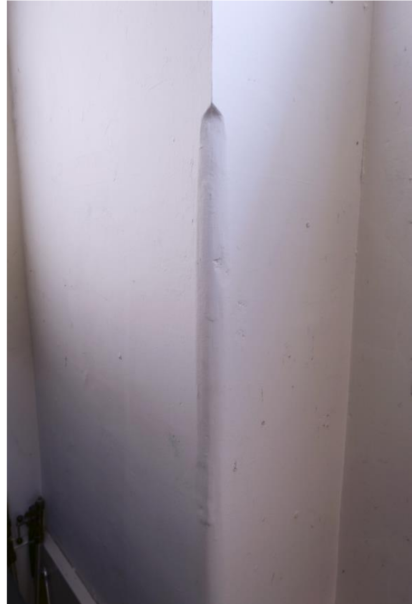
Oudere biljoening in het opgaande muurwerk bij de vestibule naast de repetitieruimte.
