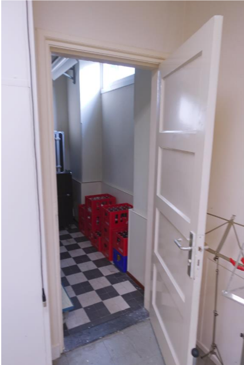
Een oude Bruynzeeldeur uit 1940 in de doorgang tussen repetitieruimte en vestibule tegen de oostgevel.
