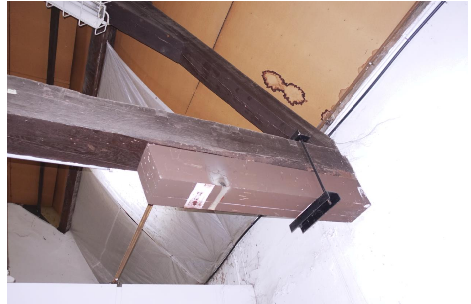
Detail van een later aangebrachte houten slof die onder de onderste dekbalk is geplaatst.
