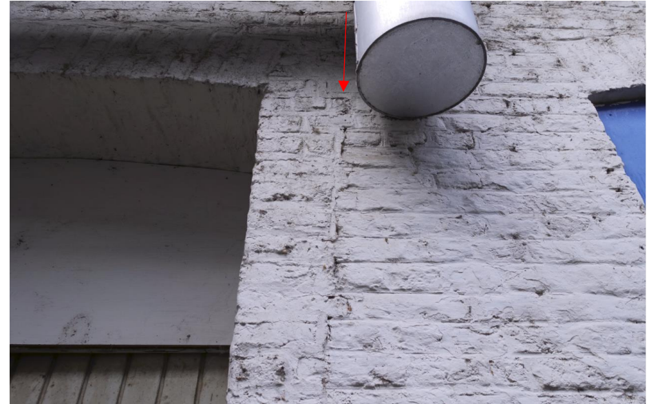
Detail van de naad (pijl) bij het herstelde muurwerk in de oostgevel na het inbrengen van de gevelopeningen in 1879-1882. Dergelijk herstelwerk is bij alle openingen in oost- en westgevel aanwezig.
