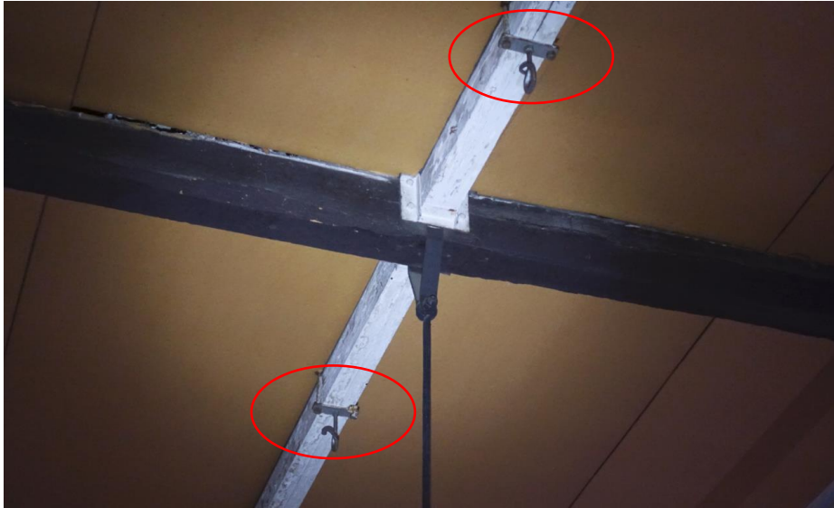
Detail van de bevestiging van de witte balken aan de oude bovenste dekbalken. Deze balken zijn in 1940 aangebracht ter bevestiging van de haken waaraan de gymnastiektoestellen gehangen konden worden.
